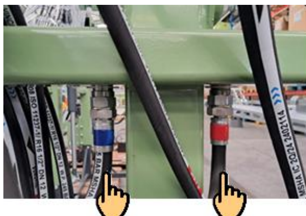
Figura 5.5 – Identificação das mangueiras hidráulicas
